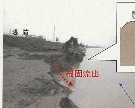
根固めの流出による侵食の拡大
