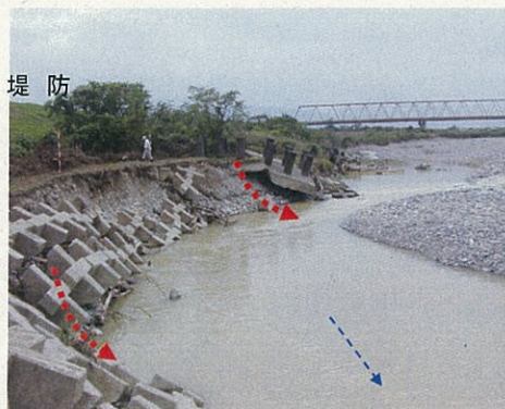
洗掘による被害
