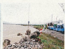
平成10年9月洪水 河岸侵食と応急復旧の状況
